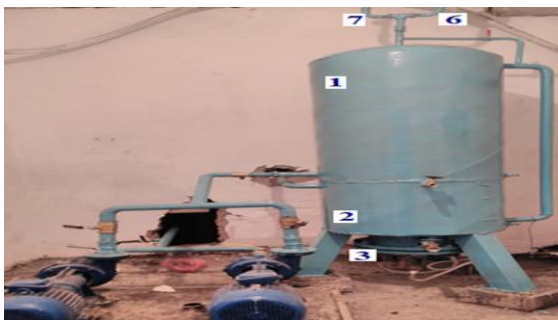
Рис. 6. Действующий водогрейный котел с компактной паровой камерой и теплообменником оригинальной конструкции: 1-корпус паровой камеры, 2-корпус для парообразующей жидкости, 3-нагревательный элемент, (4-
