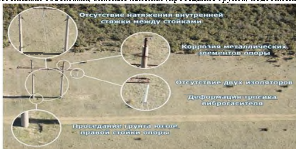
Рис.3. Обнаружение дефектов на ВЛ при помощи беспилотника.
