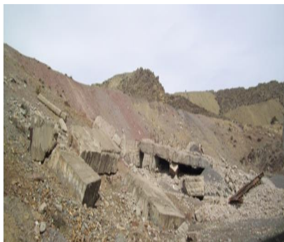
2-сүрөт. №2 калдык сактагыч. Бул калдык сактагыч ачык типетеге болуп саналат. Көлөмү 650 мин/м 3 ду ээлейт. Айылдын эң жайгашкан. Шамал болгон болгон мезгилде айылды бүтүндөй уулуу ак кум каптайт
